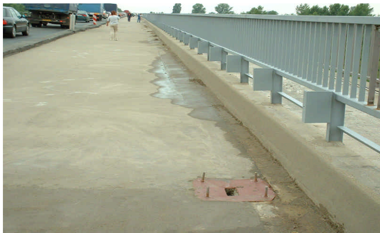
A baloldali szegély alóli szigetelésről szivárgó víz a kijavított pályalemezre folyik (2004)
