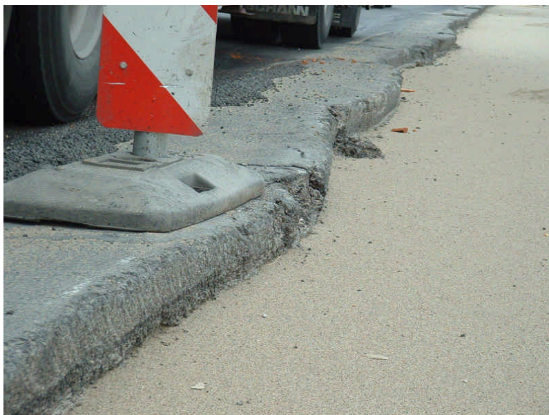
Gyűrődött, megcsúszott burkolati rendszer a váltakozó irányú nagy forgalmi terhelés hatására (2004)
