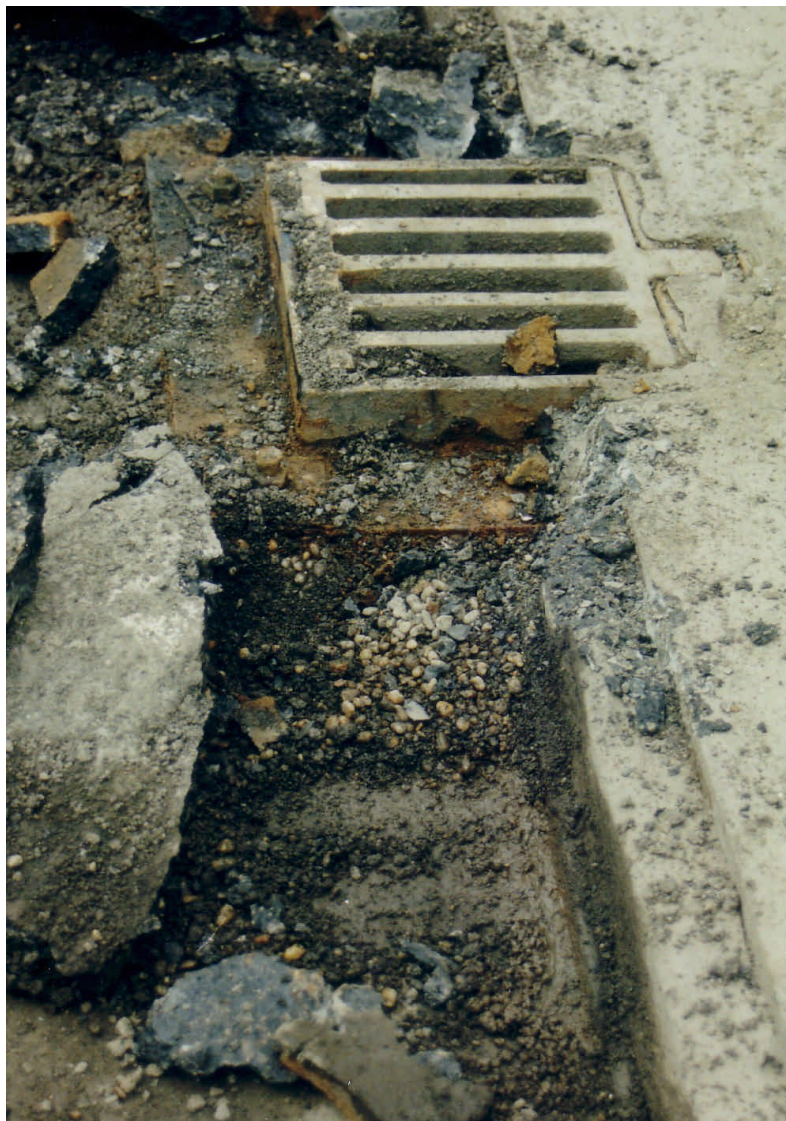
A szivárgóléc állapota a baloldali szegély melletti vápában, a víznyelőbe való bekötésnél – A gyöngykavics morzsolódik, kötés nélküli (1997)
