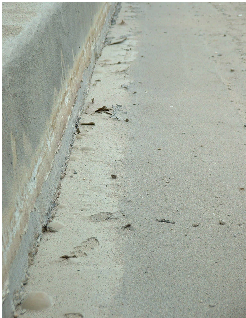
A szigetelés állapota a baloldali szegély mellett a hólyagosodások és a bontással okozott sérülések kijavítása előtt (2004)
