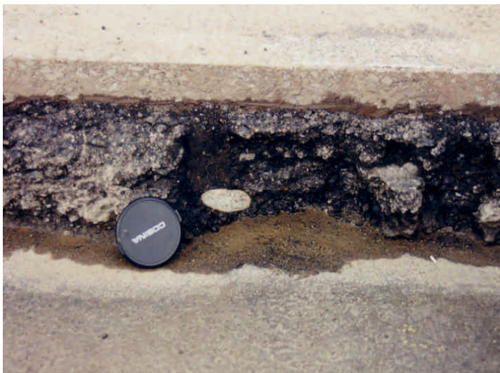
Iszapos vízszivárgás a felső bontási határon a laza kötőrétegből – A szigelelésen itt (medernyílás) a TB-50 is ép. (1997)
