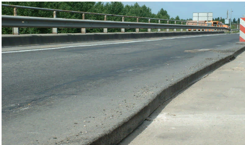
A felső, jobboldali burkolat alól kifolyt iszapos víz nyoma, a szigetelésre előkészített pályalemezen (2004)
