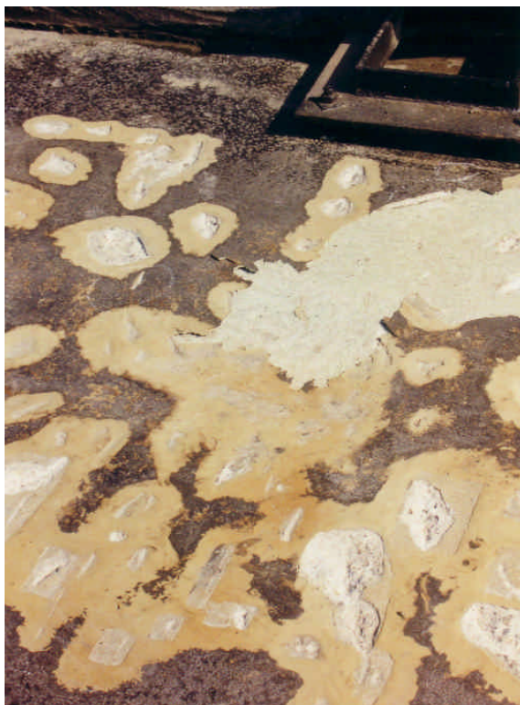
A szigetelésen feltárt sérülések és hólyag foltok kivágásuk és körbecsiszolásuk után (1997)
