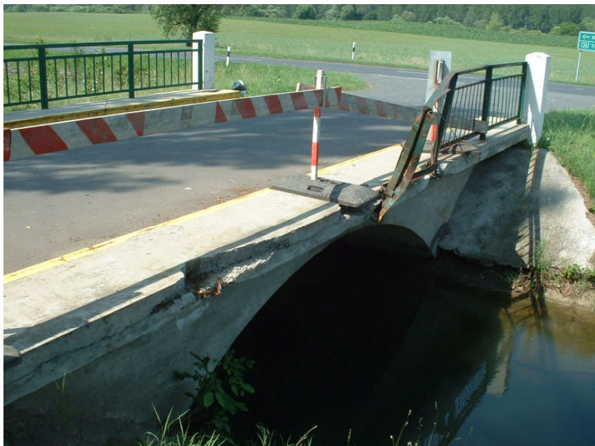
Tiszaörsfürdői csatorna híd sérülése
